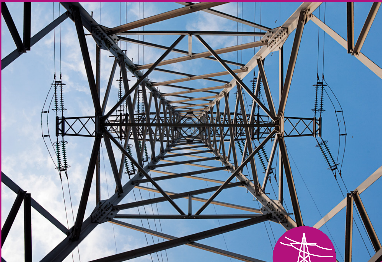
Hoogspanningsmast op industrieterrein Moerdijk. Foto: Branko de Lang
